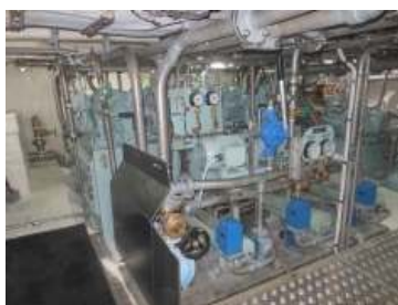
油圧ポンプユニット
