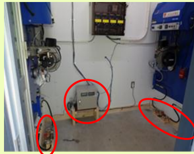
燃油・電力消費量等計測機器
