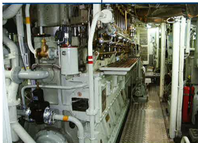
機関室内(主機)
