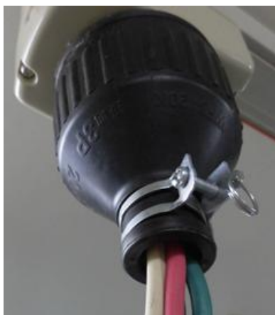
写真3 漁期中の電蝕対策 （接続状態の維持）
