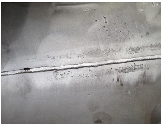
写真2 ステンレスの電蝕（劣化）の発生
