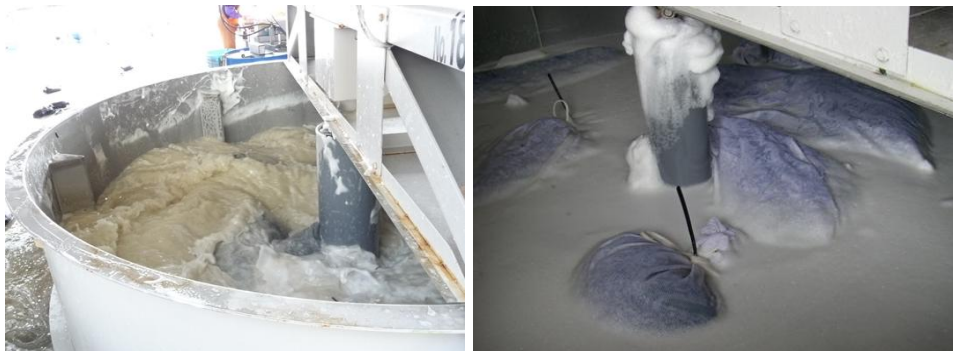
写真 25 塩ビパイプ製の回転軸カバーへの網袋の絡みの発生
